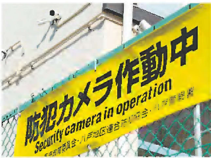
小学校の敷地に設置された防犯カメラ。作動中の横断幕を掲げることも抑止効果がある(12日、八戸市立旭ヶ丘小で)
